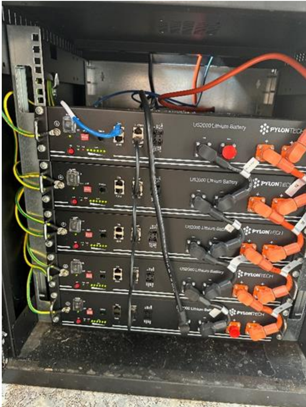
Figura 23: Foto sistema di accumulo
