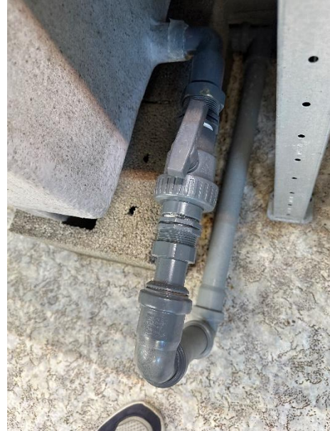
Figura 41: Dettaglio scarico vasche e tubazioni collegamento impianto di filtraggio
