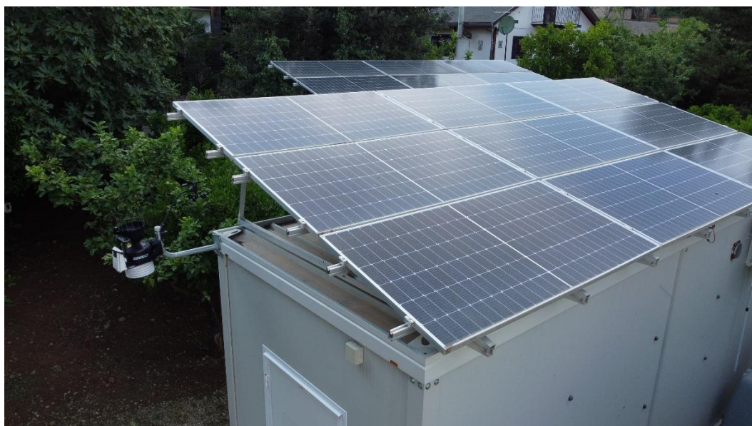
Figura 16: Particolare posizionamento dei moduli fotovoltaici
