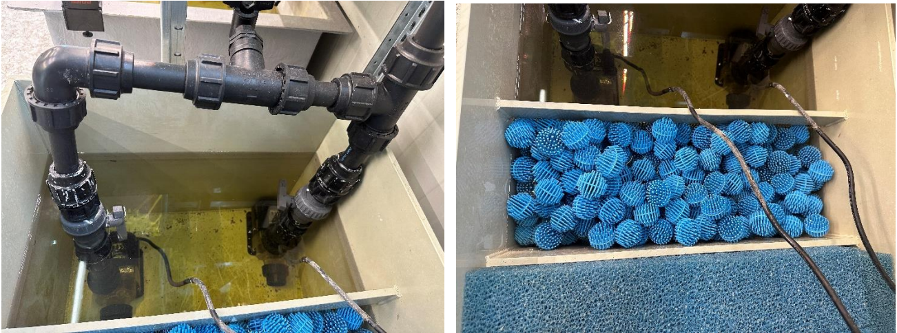
Figura 43: Dettaglio filtro meccanico e sistema di pompaggio costituito da n. 2 pompe che possono essere azionate anche in parallelo
