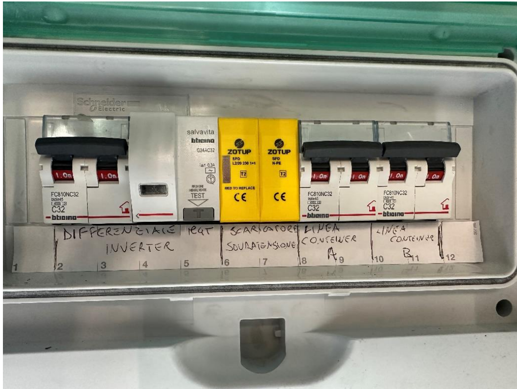
Figura 27: Quadro AC a protezione della linea di alimentazione dei BOX
