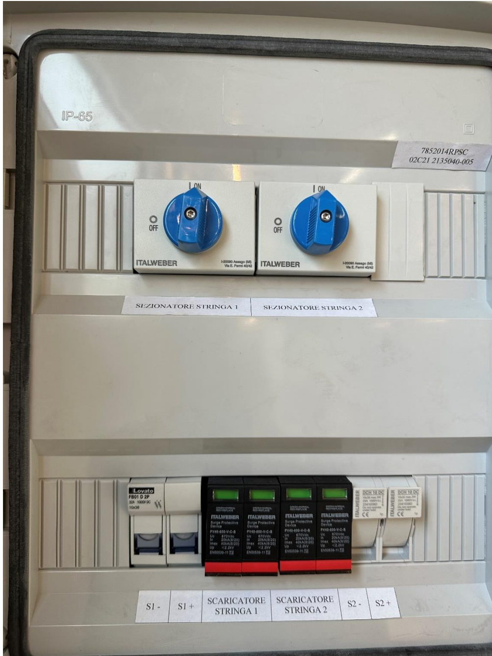
Figura 19: Quadro di campo con dispositivi di protezione
