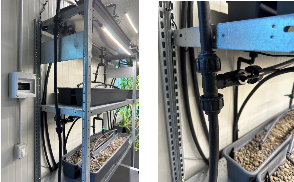
Figura 44: Dettaglio tubazione di mandata acqua dal sistema di filtraggio alle vertical farm
