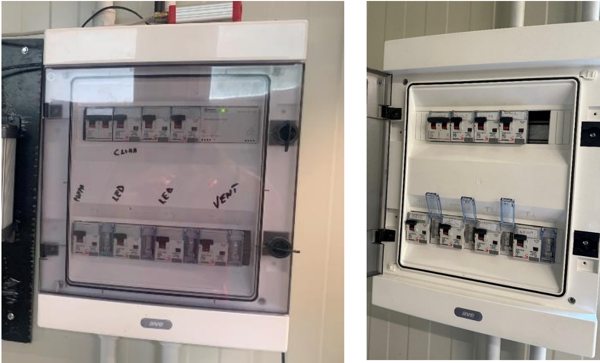
Figura 29: Quadro generale utenze BOX n. 1 e n.2
